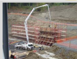
تصویر شماره ۳۲.۱۳. پمپ بتن
