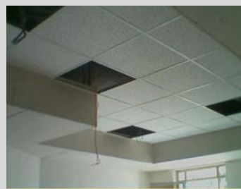
تصویر شماره ۱۳.۱۰. تایل‌های گچی سقف کاذب
