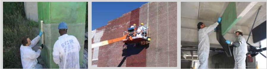
تصویر شماره ۲۰۲۰. چند نمونه تقویت سازه توسط پوشش‌های FRP
