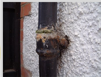
تصویر شماره ۱۱.۱۰. ایجاد خوردگی در فلزات در مجاورت گچ
