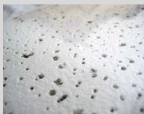
تصویر شماره ۲.۱۶. حفره‌های ریز موجود در مصالح آکوستیک
