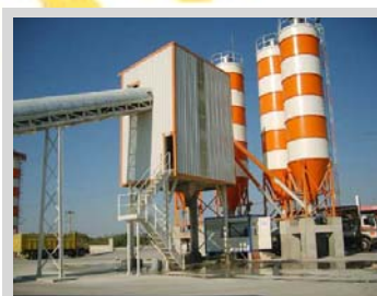
تصویر شماره ۴.۱۳. دستگاه بتن ساز
