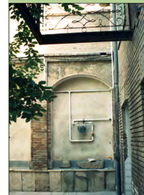
حضور انواع لوله‌کشی و سیم‌کشی‌های تأسیساتی روی دیوارهای خانه - همدان
